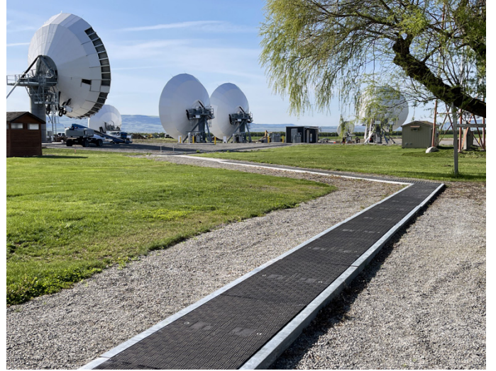
Fibrelite Trenwa kanal ve kapak sistemi antenlerden kontrol odalarına giden kabloları korumakta ve onlara hızlı erişim sağlamaktadır.
