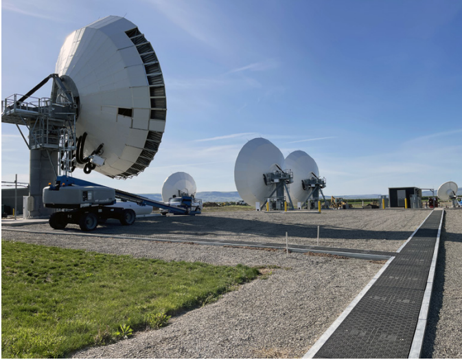
Fibrelite Trenwa kanal ve kapak sistemi kritik göreve sahip uydu tesisine monte edildi.
