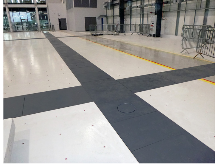
Fibrelite kanal kapakları manuel olarak güvenle kaldırmak üzere tasarlanmıştır
