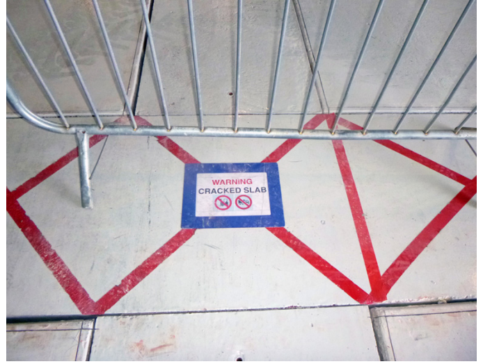
Önceden var olan D400 beton kaplamalar bazı bölgelerde çatlamıştı
