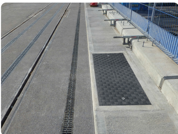
gleisnahe passgenaue Schachtabdeckungen
