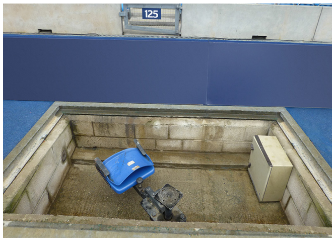
Una postazione per telecamera già esistente da coprire con i chiusini modulari Fibrelite
