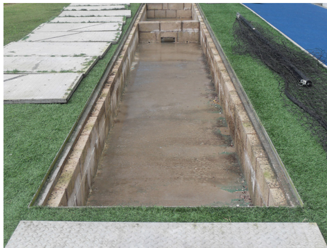
Una postazione per telecamere da coprire con i chiusini in materiale composito prodotti da Fibrelite
