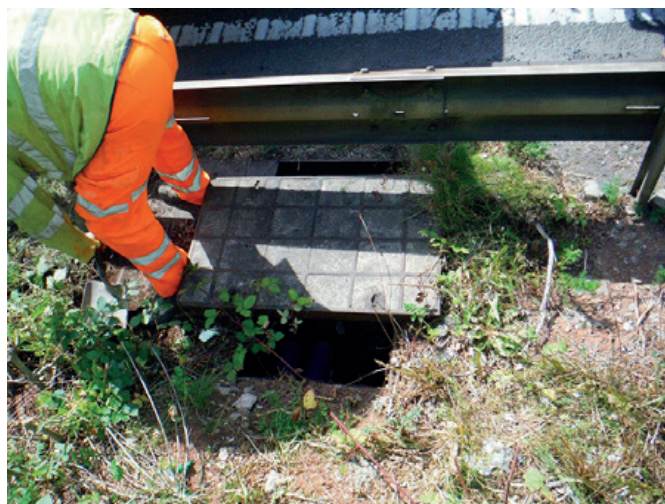
Uszkodzona pokrywa żeliwna i betonowa
