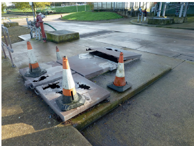
Poprzednio zainstalowane niebezpieczne i skorodowane pokrywy stalowe
