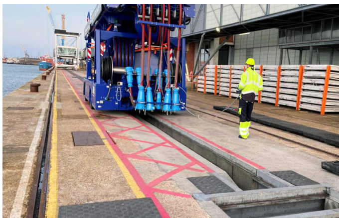
OPS (Système d'alimentation électrique onshore) pour le terminal de croisière du Royaume-Uni
