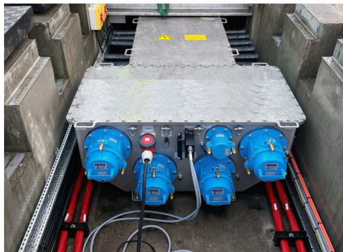
Solution durable / légère requise pour permettre l'accès aux fosses de câbles
