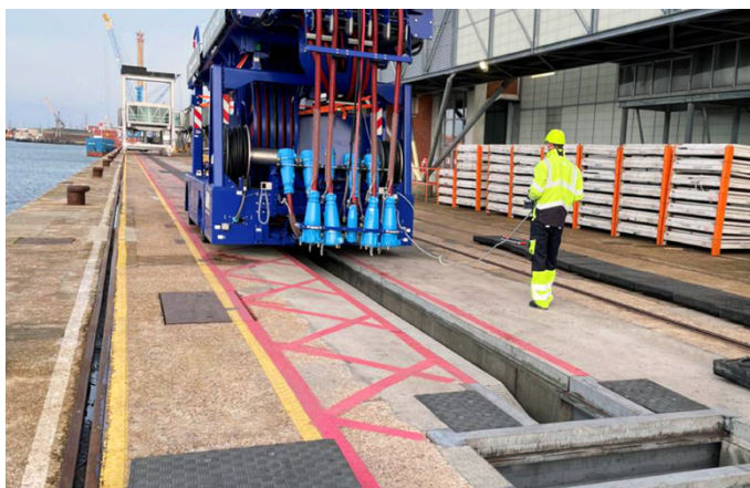
OPS (Onshore Power Supply) para terminal de cruzeiros no Reino Unido.
