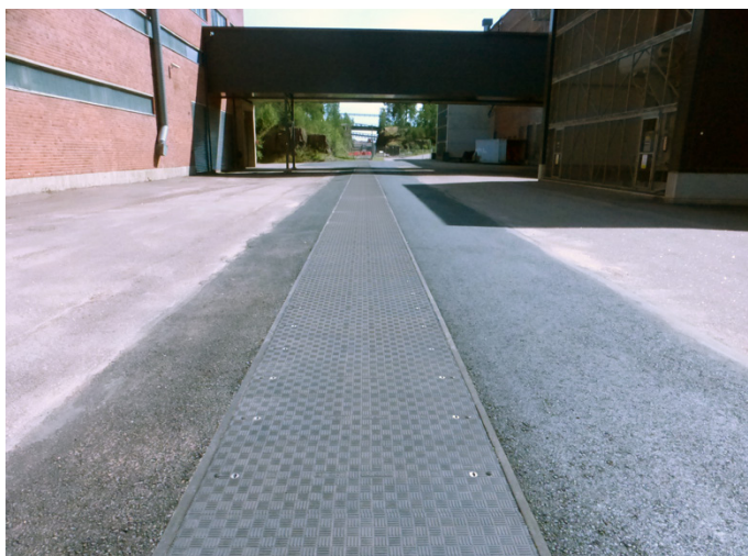
Une section droite de panneaux Fibrelite FM500-1265-117-D400-2RB entre les halls de serveurs
