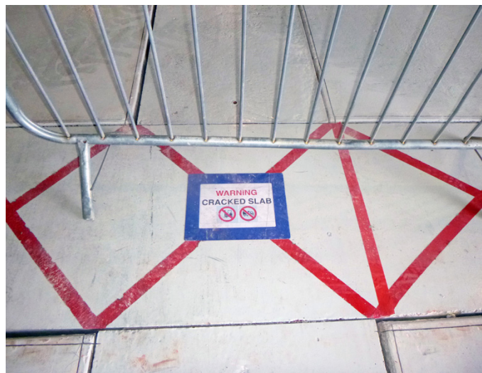
As coberturas de betão D400 anteriormente existentes apresentavam fissuras em algumas áreas
