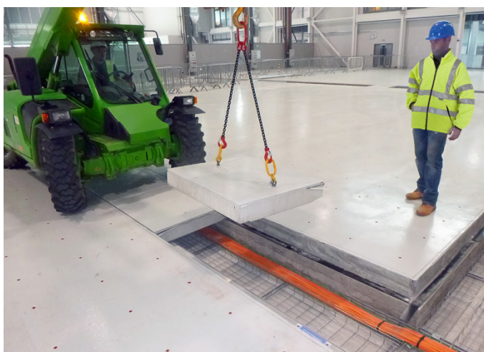
A remoção das coberturas anteriormente existentes foi uma operação dispendiosa e morosa
