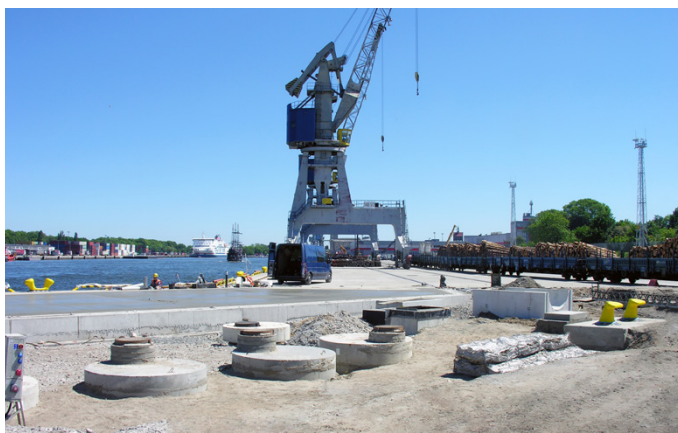
Le port de Gdansk a investi dans l'extension et la modernisation du quai Oliwskie avec une longueur totale d'extension de 1 200 mètres
