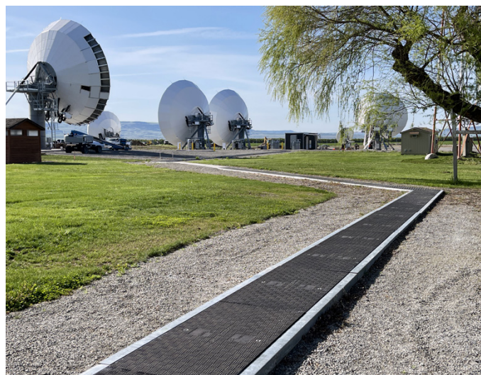
O sistema de valas e coberturas Fibrelite Trenwa protege e permite um acesso rápido e seguro aos cabos que vão desde as antenas até às salas de controlo
